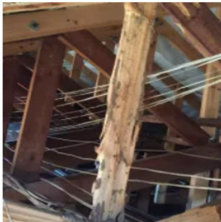
Gambar 15. Kondisi Awal Rangka Atap
