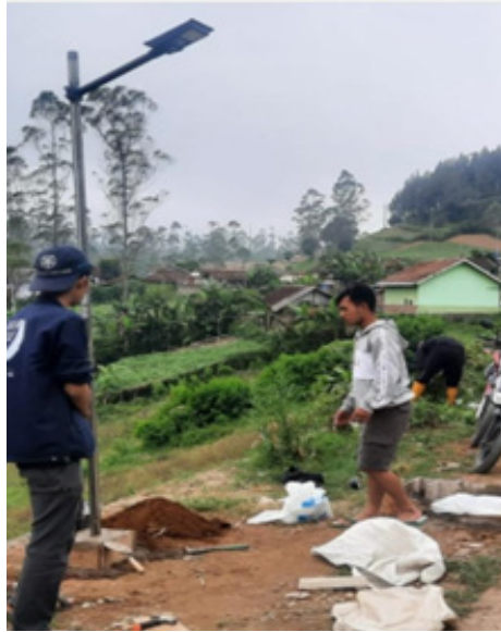
Gambar 2. Lampu Penerangan Jalan Umum Solar Cell Panel
